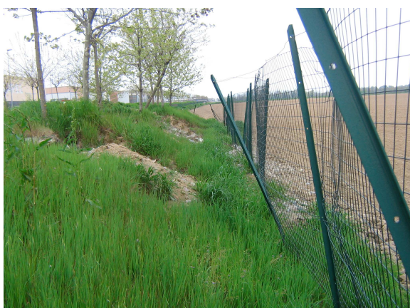
Tracce effetti dell'alluvione d'ottobre 2009 sette mesi dopo
